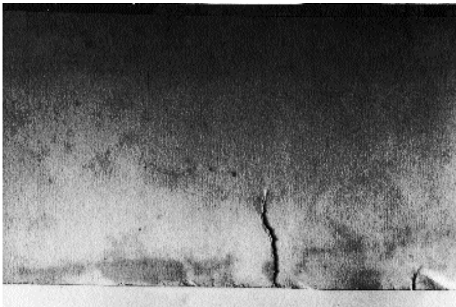
Fig. 4. Detalle de rotos por manipulación incorrecta
