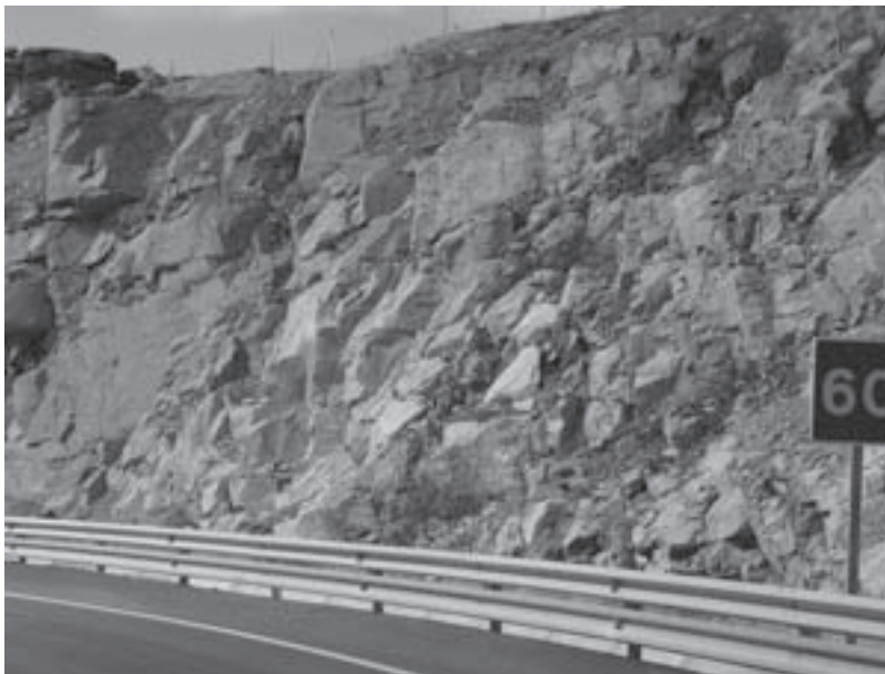
FOTO 6 Estética del deterioro: paredes de excavación en la Autovía de Ávila a Salamanca.
