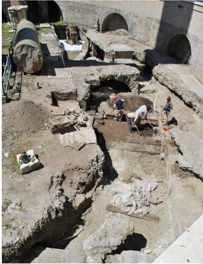
FIG. 14. Veduta dall'alto dello scavo del 2013 per il ripristino dell'emiciclo di Pio VII. Nella trincea si vede la prima concameratio sotto la pavimentazione del porticato settentrionale del cortile della colonna Traiana (foto R. Meneghini).
