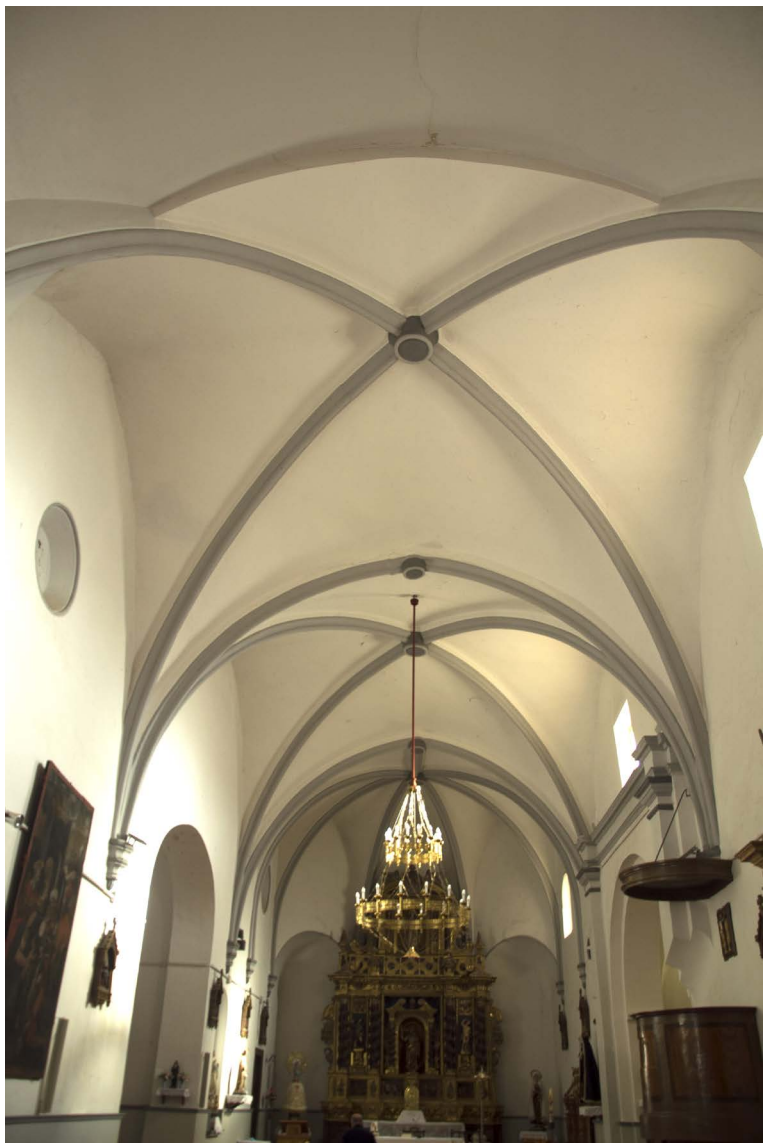
Fig. 2: Bóvedas de la nave central de la iglesia de Santa María de Bulbunte. (Fotografía del autor)
